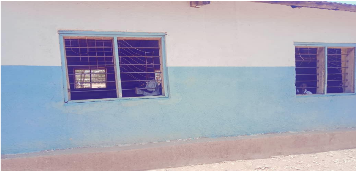
Picha 2: Picha hapo juu ikionesha ubora hafifu wa vifaa vilivyotumika (Wire mesh) kwa kazi ya ukarabati wa madirisha ya vyumba vya madarasa katika shule ya msingi Bwanga “A”.
